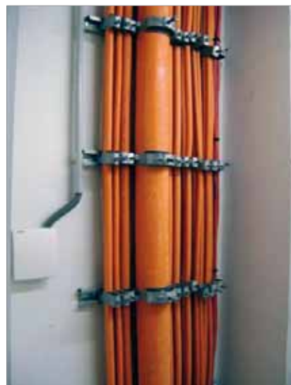
Obr. 2 Správne uložené káble.
