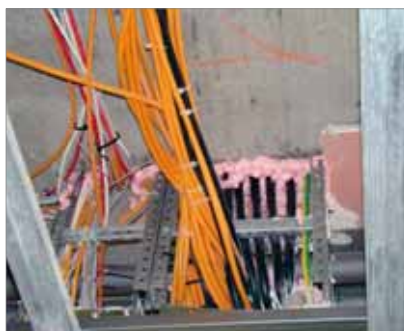
Obr. 1 Nesprávne uložené káble.
